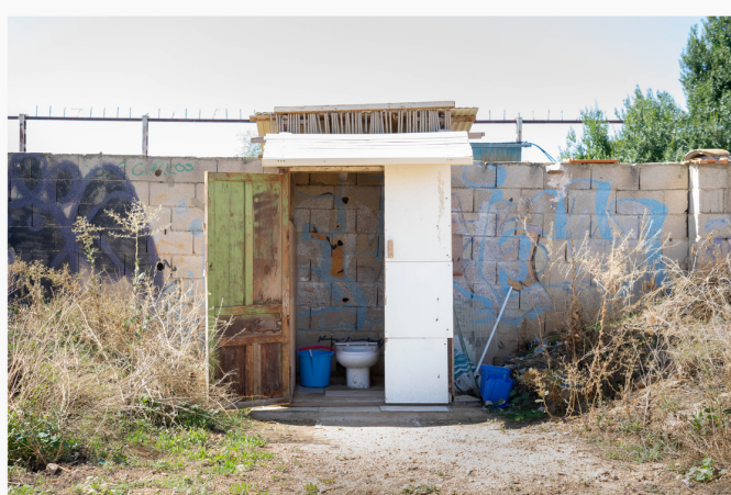
SISTEMA DE SANEAMIENTO DESPROVISTO DE DESAGÜE Y AGUA CORRIENTE
